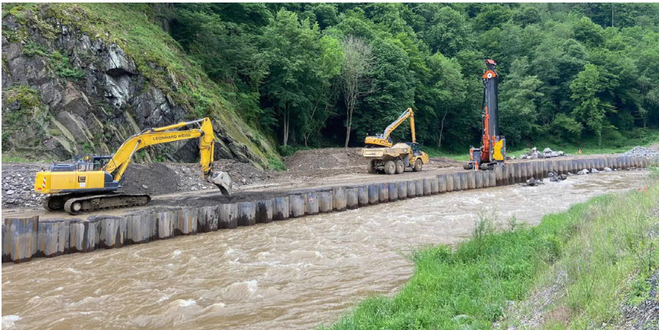
Abb. 1: Arbeiten am Bahndamm und das Einbringen der Spundwände zur Verbesserung der Hochwasserresilienz
